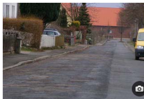
Die Lübecker Straße braucht einen Neuausbau Fotostrecke Wennigsen: Die Lübecker Straße braucht einen Neuausbau
